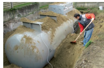
Protezione catodica già collegata Cathodic protection already connected
