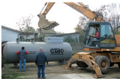
Trasporto e scarico nello scavo con gru Delivery and unload in the hole with crane
